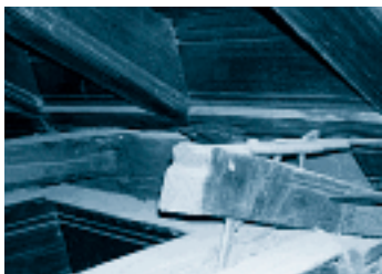
Particolare del dissesto strutturale
